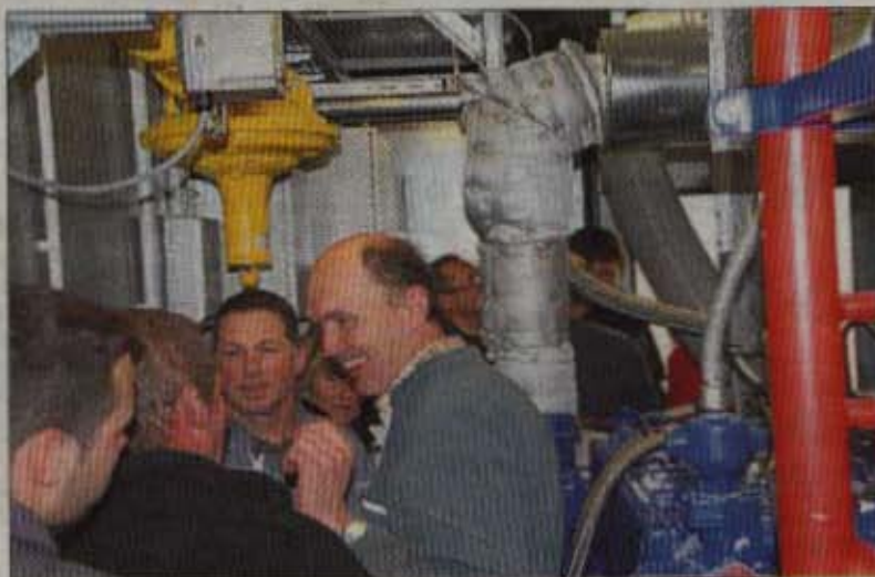
Explication dans le cogénérateur.
